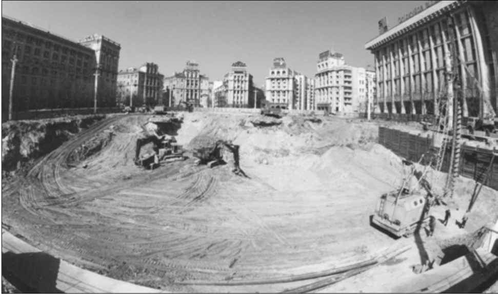
Рис. 1. Вигляд з південно-східної сторони котловану будівництва на Майдані Незалежності, 2001 р. Фото К. Шматова
